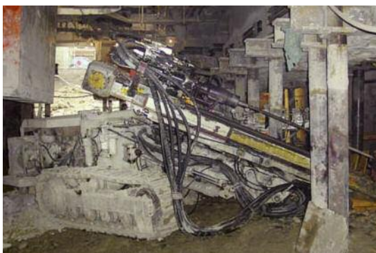
Erhöhung der Tragfähigkeit des Baugrundes durch Bodeninjektionen unter extrem beengten Verhältnissen (unter Gebäude)
