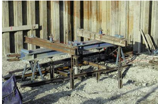
Wenn der Bauherr auf Nummer sicher gehen will; statischer Pfahlbelastungsversuch für Coop-Neubau in Nidau; mit 4 Zugpfählen wird ein Druckpfahl auf die Tragsicherheit geprüft.
